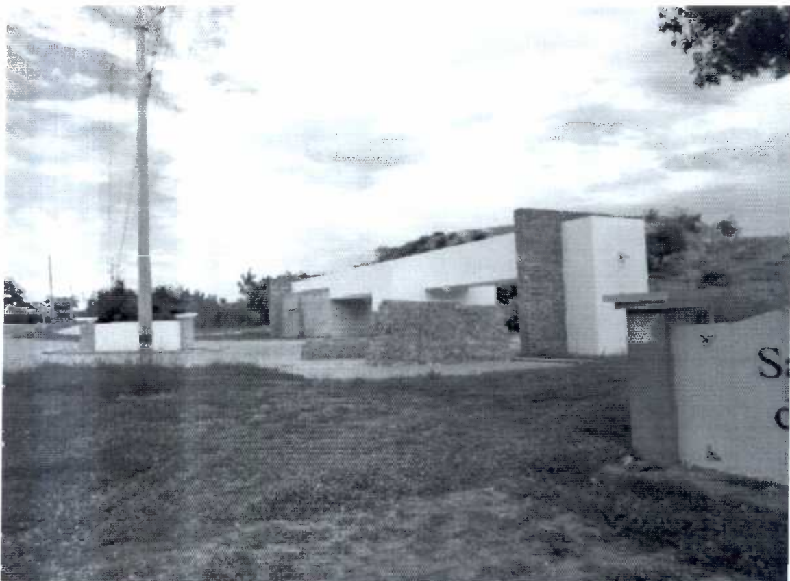
Foto No. 2 Panorámica del lote afectado sobre la vía en el Km. 6 Girardot - Tocaima. Construcción portal entrada etapa II Condominio Santa María del Campo.-
